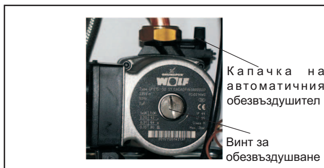
Снимка: Автоматичен обезвъздушител на помпата за отоплителния кръг
